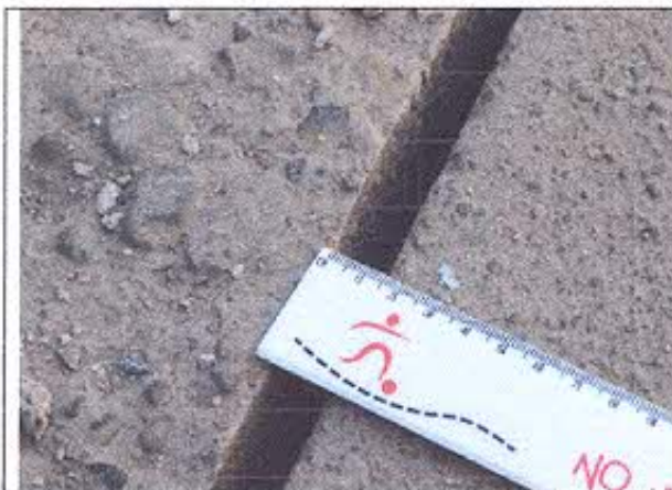
Fotografía nro. 1: Tamaño de grieta en vía de acceso a Escuela La Inmaculada. Fuente: INPC R7
